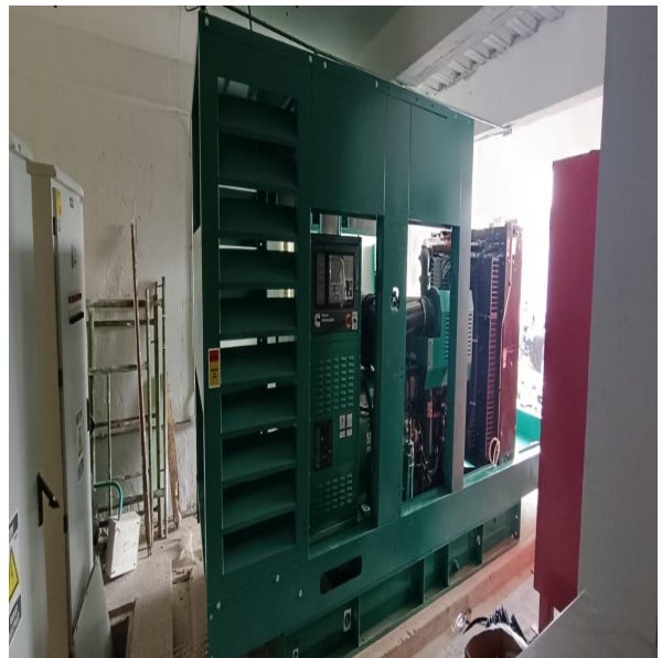
GENERADOR ELECTRICO DE 500KVA MARCA CUMMINS
